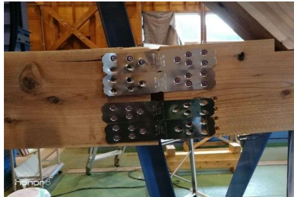
Fig1-6 下弦材接手部の損傷状況
