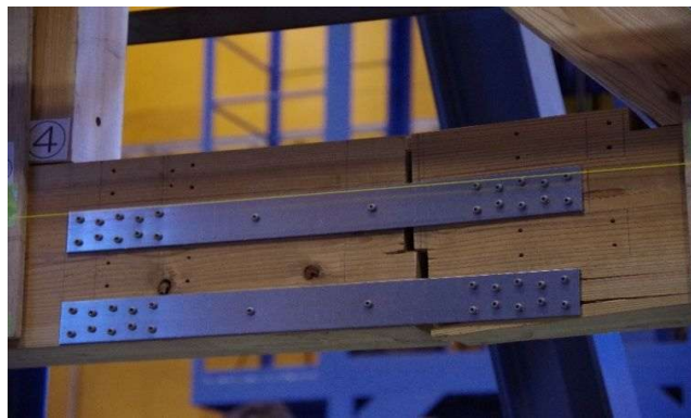
Fig2-6 下弦材接手部の破壊状況(2) (測定者側)
