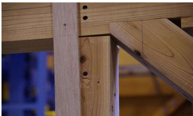
Fig2-9 上弦材と束材の変形状況
