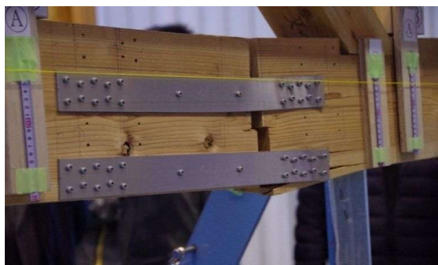
Fig2-5 下弦材接手部の破壊状況(1) (測定者側)
