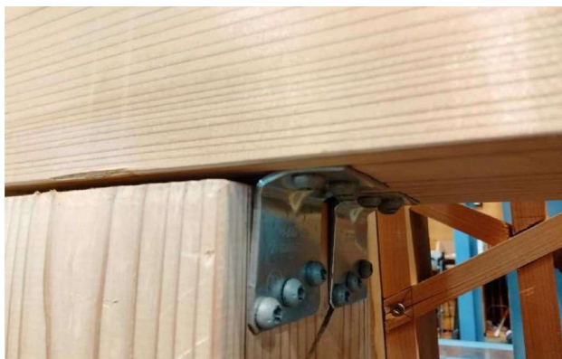
Fig1-7 束材と上弦材接手部の変形
