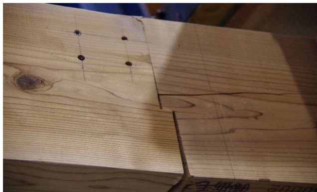
Fig2-8 上弦材接手部の変形状況
